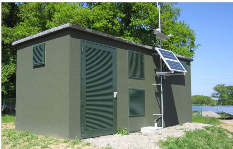
Exemple de poste de livraison
