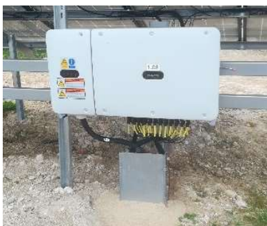
Vues sur un onduleur et câble enfoui dans le sol – Source TotalEnergies
